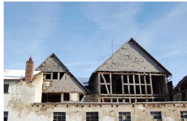
Blick auf ein stark sanierungsbedürftiges Gehöft in zentraler Ortslage.
