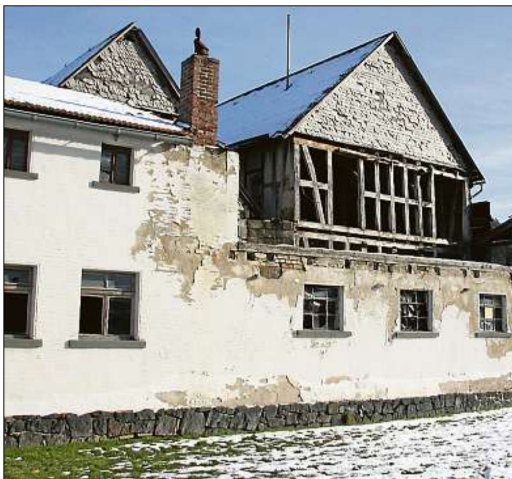
Zur Gestaltung der Dorfmitte in Herzhausen könnte auch der Abriss dieses Anwesens von Manfred und Heidrun Weber beitragen. Den entstehenden Platz würden sie nämlich der Gemeinde zur Verfügung stellen. (Foto: Valentin)
